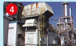
4 尼崎エネルギーサービス(株) 兵庫県尼崎市 発電設備/4,000kW 種類/天然ガス
